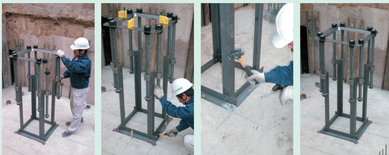
8 アンカーボルトの固定 → 9 水平位置調節 → 10 アンカーフレームの固定 → 11 セット完了
