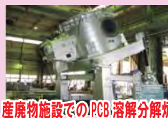
産廃物施設でのPCB溶解分解炉
