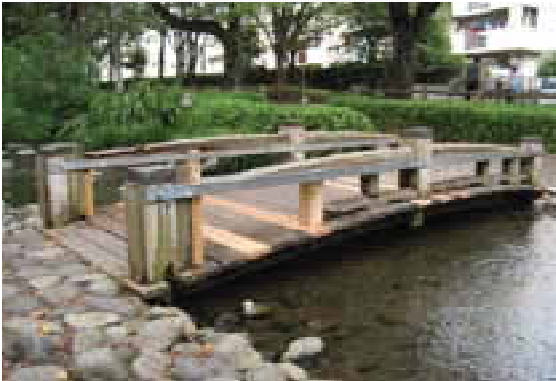
① 改修前(天然木が腐っている)
