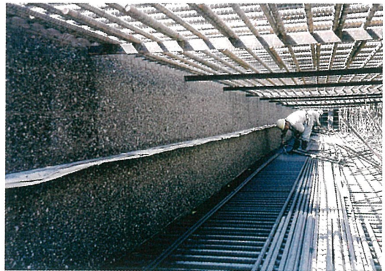
土木：浄水場での使用例
