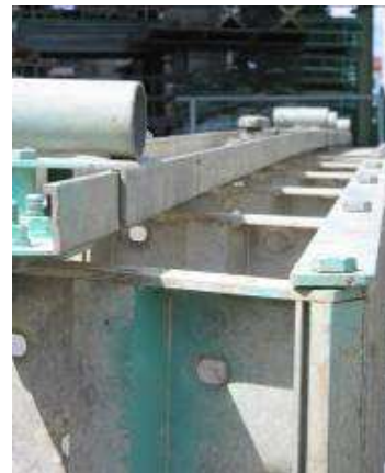
フレーム曲り交換
