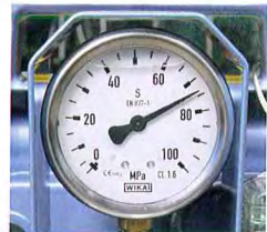
油圧ポンプの 最大圧力
